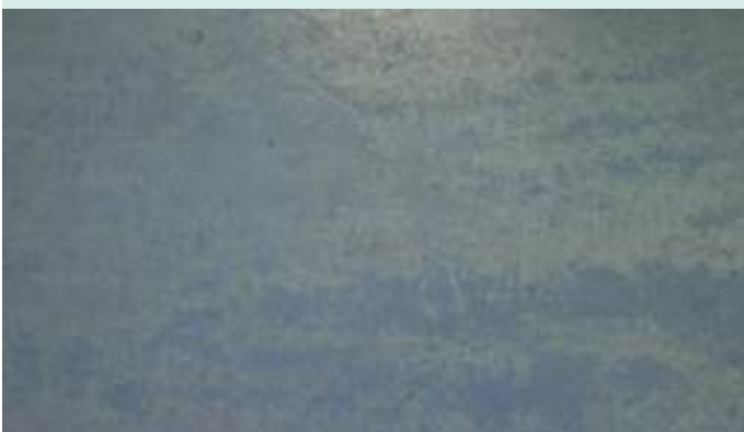
Abputzen einer Hartbeschichtung durch Grundreinigerrückstände.
